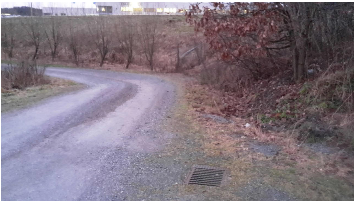
Figur 12. Dagvattenbrunn längst med Järnbrotts Prästväg där dagvatten leds ner till befintligt dagvattennät.
