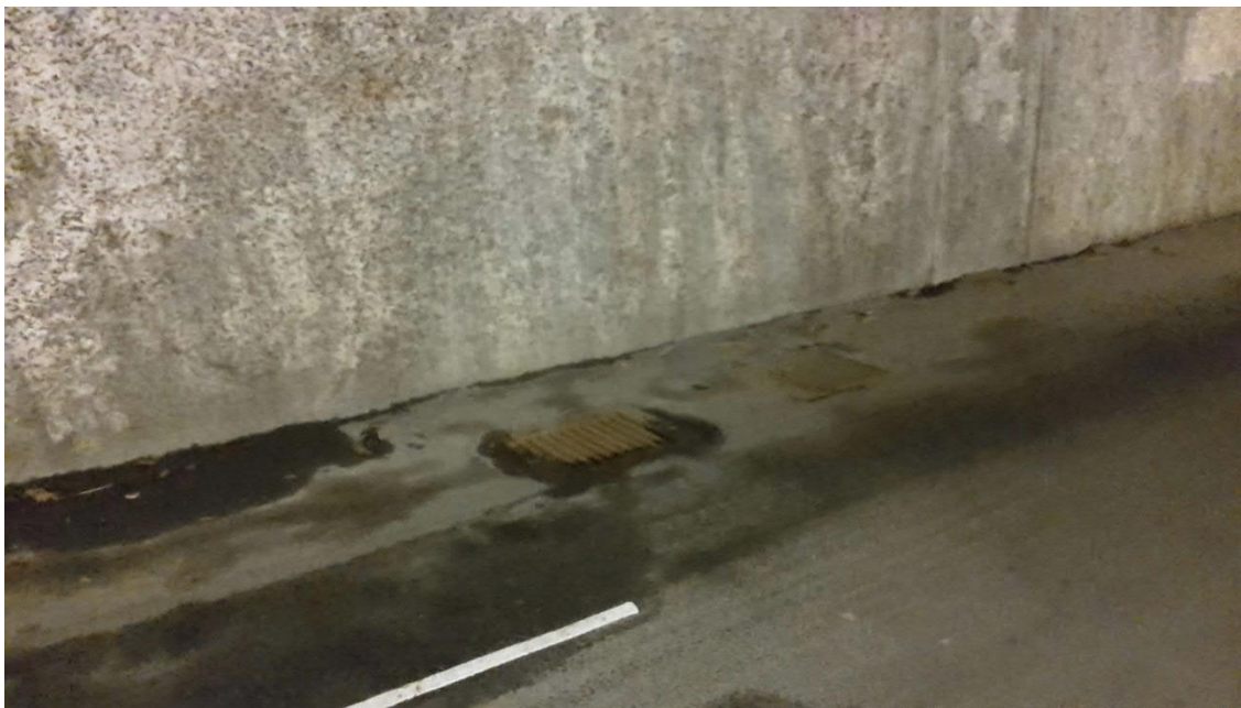
Figur 14. Dagvattenbrunn i GC-tunnel, sydväst om område A.
